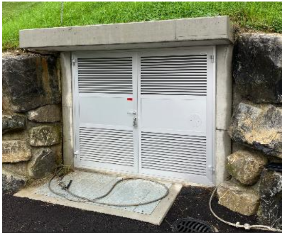
a: baugleiche Transformatorstation zur Illustration
